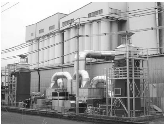
消臭プラント設備
