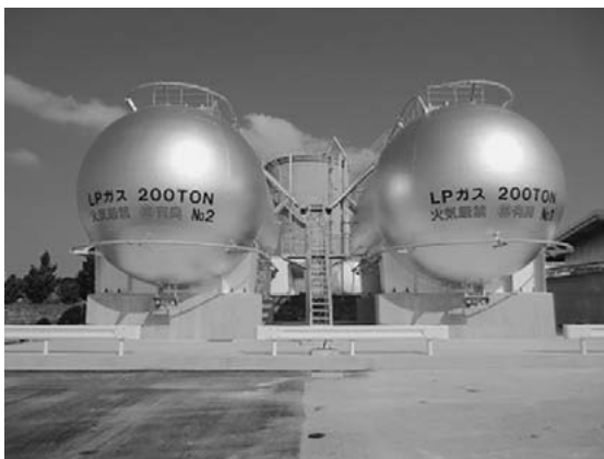
LPガスプラント
