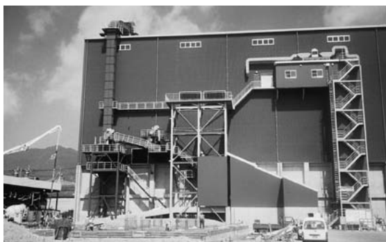
パーク・オガ搬送設備
