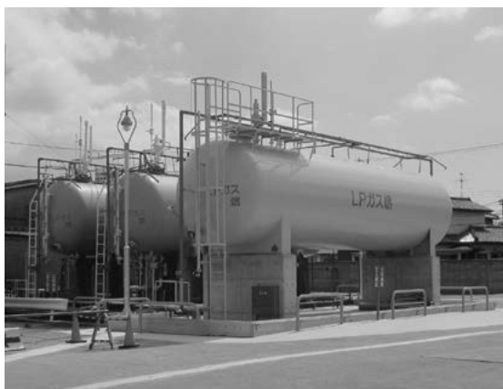
LPガスプラント
